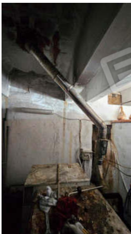
Tettoia alloggiamento impianti
