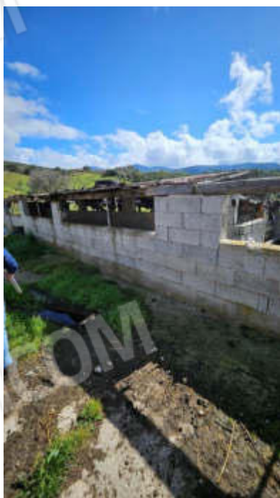
Vista struttura precaria Tettoia ( su mappale 564)
