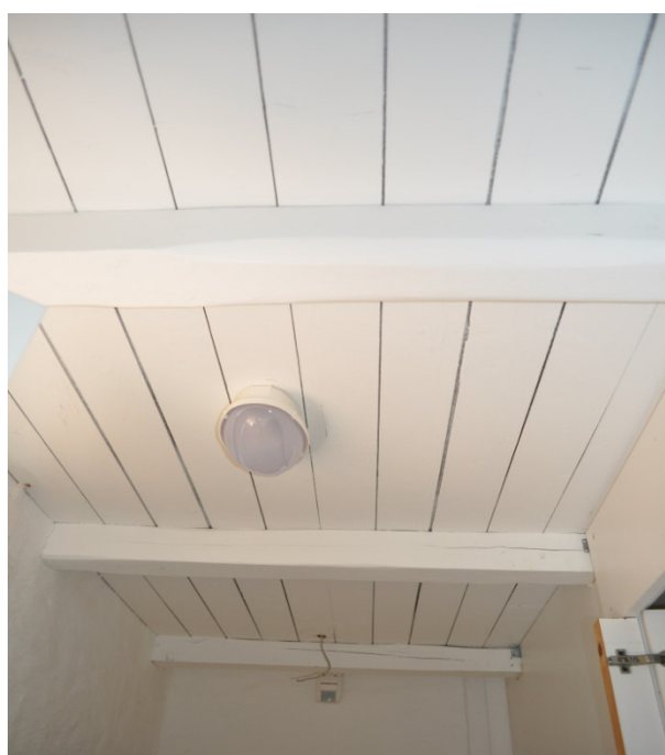
Figg. 29-30-31. Vista dello spazio sfruttato nel sottotetto ove è ubicato il boiler- Dettaglio del solaio realizzato in travi in legno e assito di tavole
