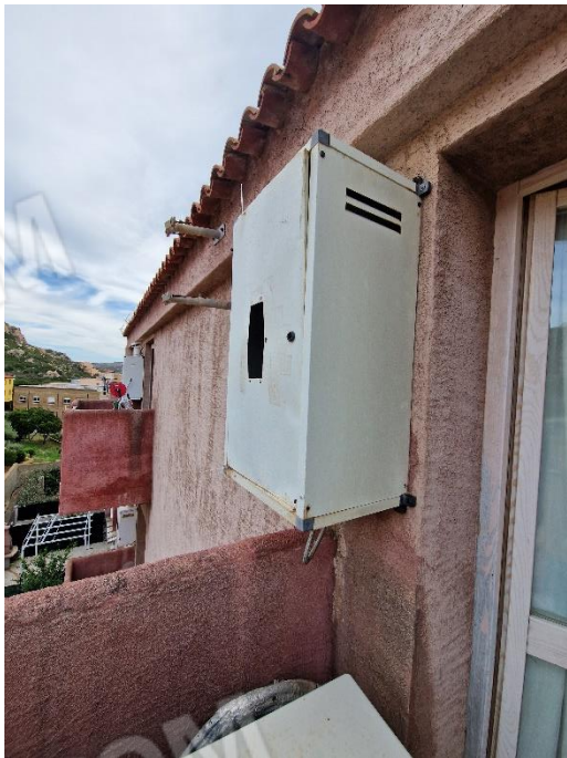
Balcone con caldaia a gas acs
