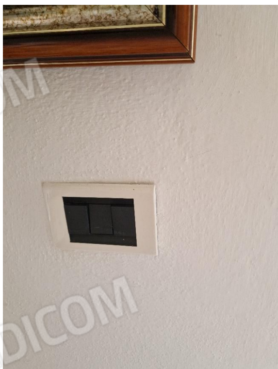
Dettagli finiture impianto elettrico
