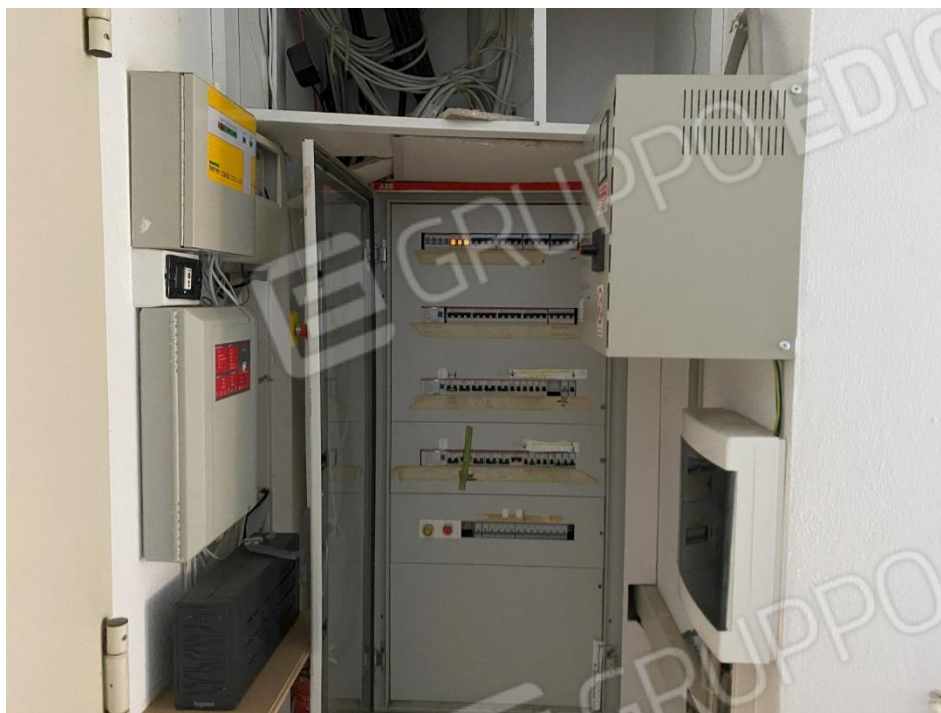
Zona quadri elettrici piano terra
