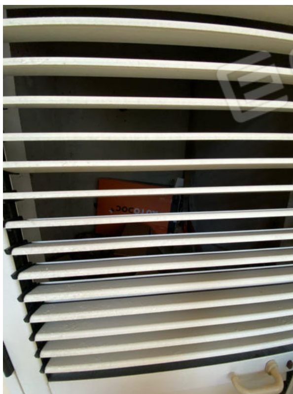
Foto n°6 particolare del locale tecnico
