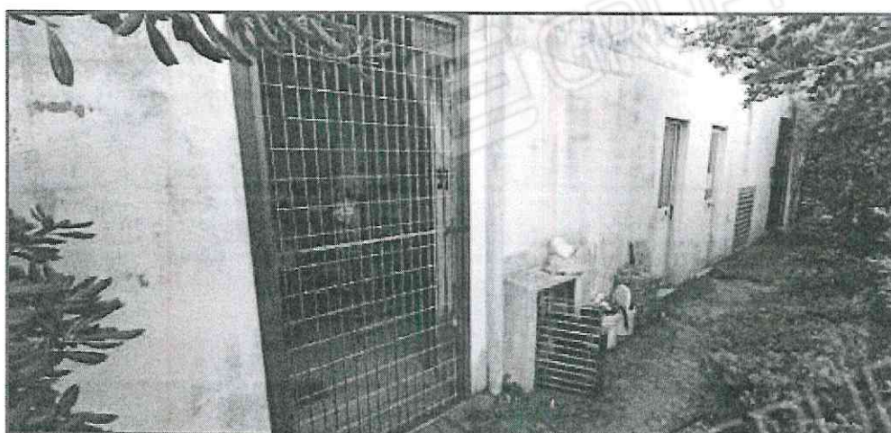
FOTO 44 LOCALI TECNICI INGRESSI
