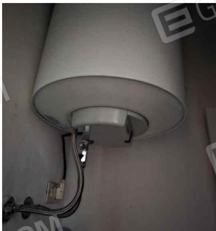
Foto n° 19 – Boiler ACS lavanderia
