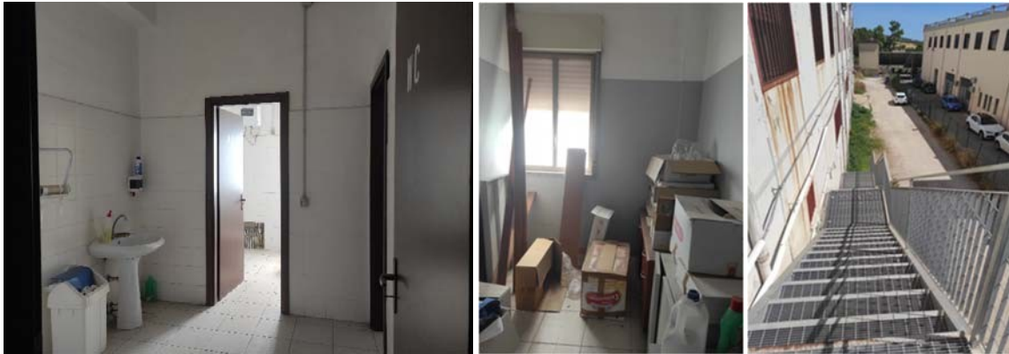
Figura 16 – Vista intera del piano primo (sub 21). A dx la scala di emergenza
