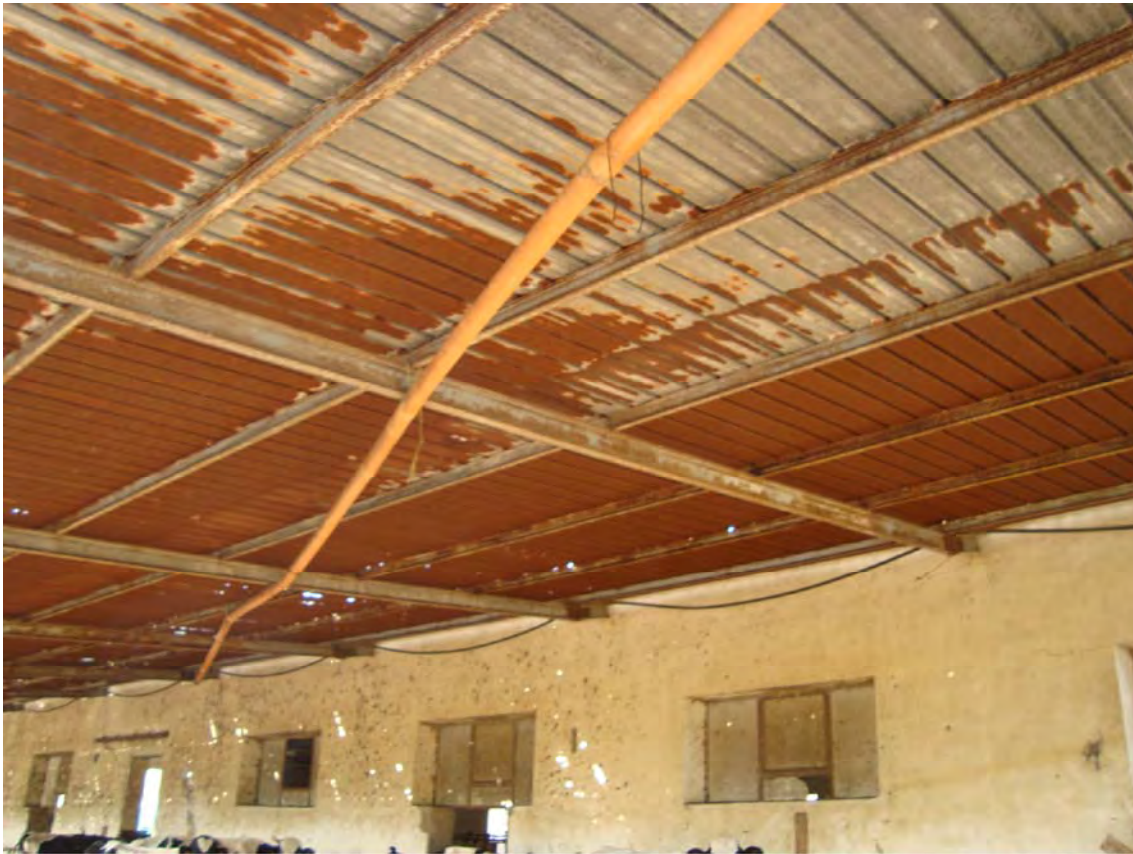
COPERTURA STALLA BOVINI in condizioni fatiscente
