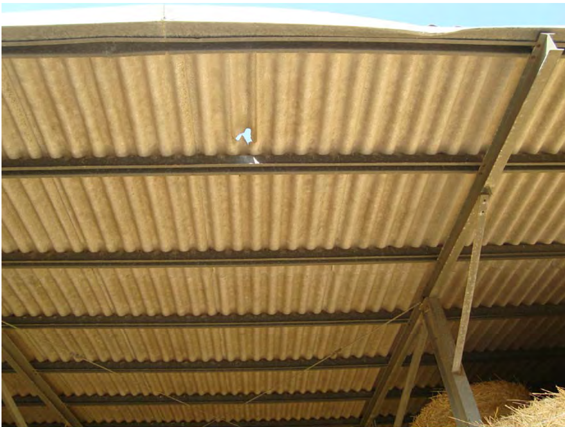
COPERTURA FIENILE in condizioni fatiscente
