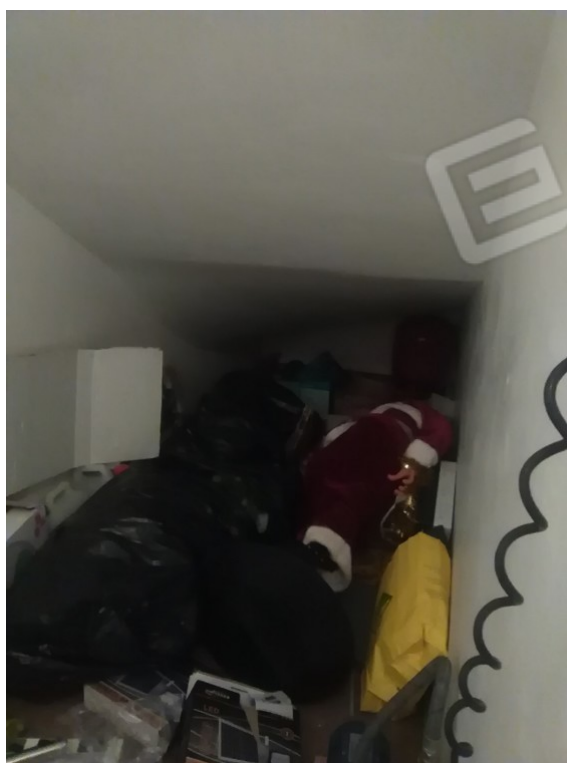
Fotografia J.14 - Particolare di un vano con accesso dal locale di cui al sub 5 ma rientrante nel confinante sub 6. Nel locale in questione è presente una botola di ispezione di una vasca idrica posta sotto il confinante sub 6.
