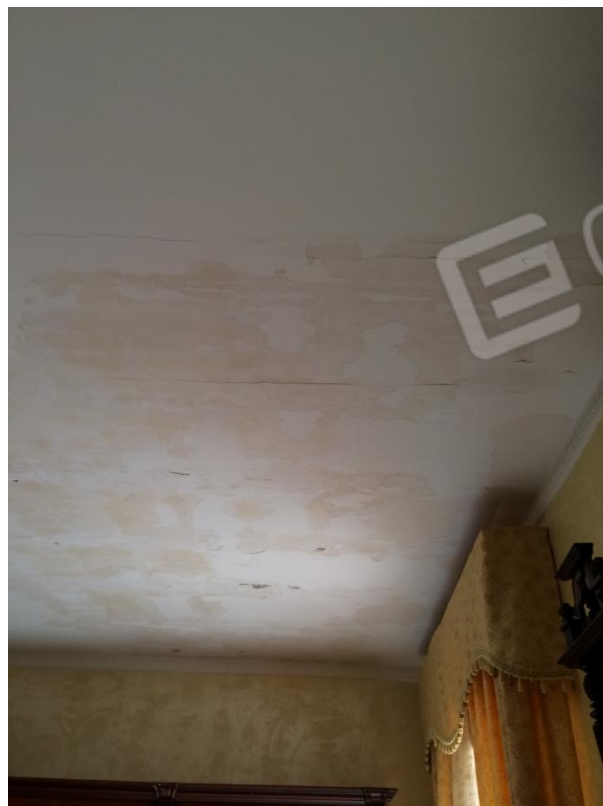
Danni all'interno dell'appartamento sito al secondo piano, causati dalle infiltrazioni
