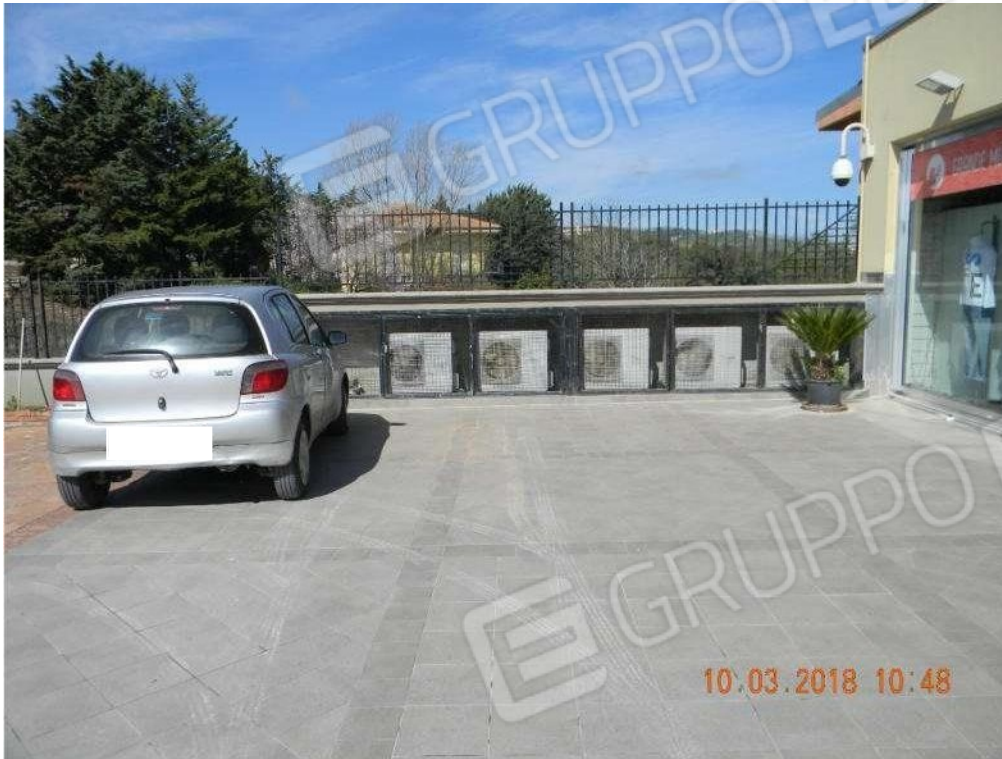
Foto 11 - Unità esterne dell'impianto di climatizzazione.
