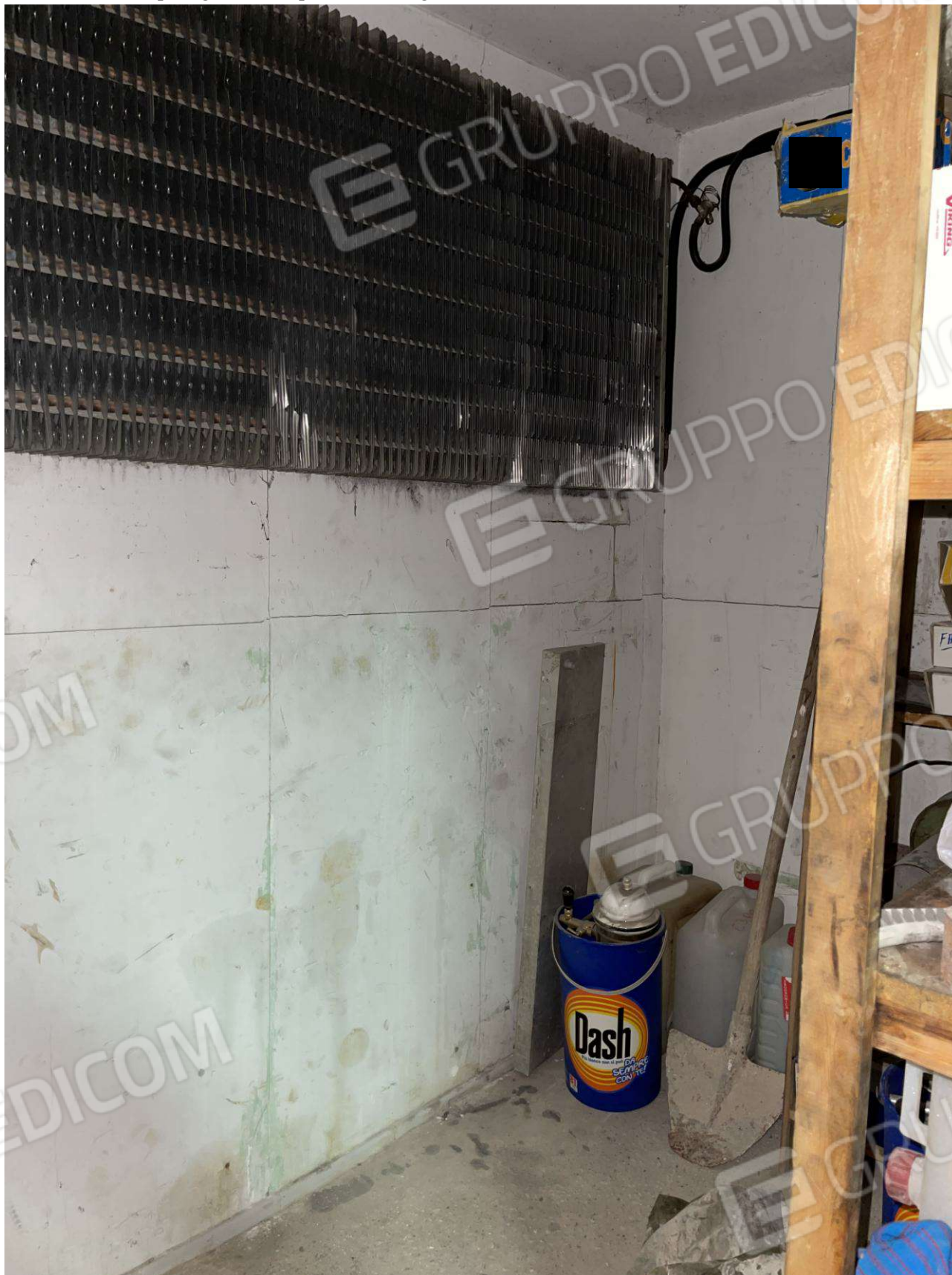
Foto 4 – Locale ripostiglio con impianto di refrigerazione
