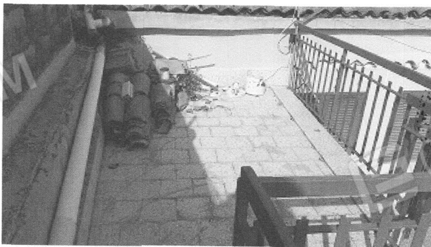
Foto n°3-vista panoramica del terrazzo;
