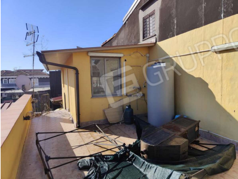
Foto n. 24: costruzione abusiva rinvenuta sul lastrico solare.
