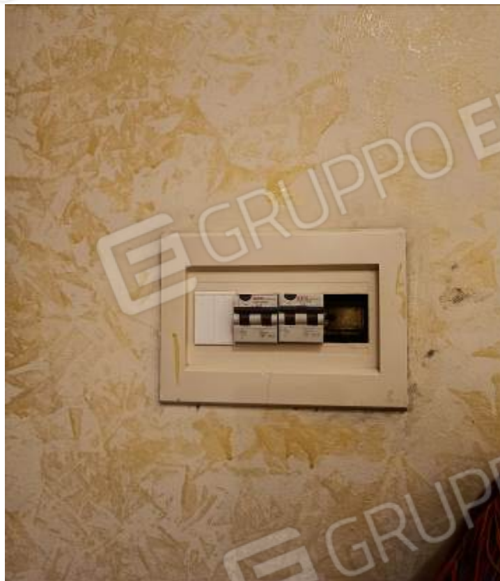
Foto 71 – Quadro elettrico generale
