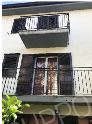
-Foto 14 (particolare frontalino)
