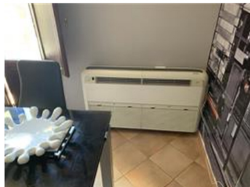
foto n. 12: impianto di climatizzazione invernale ed estiva
