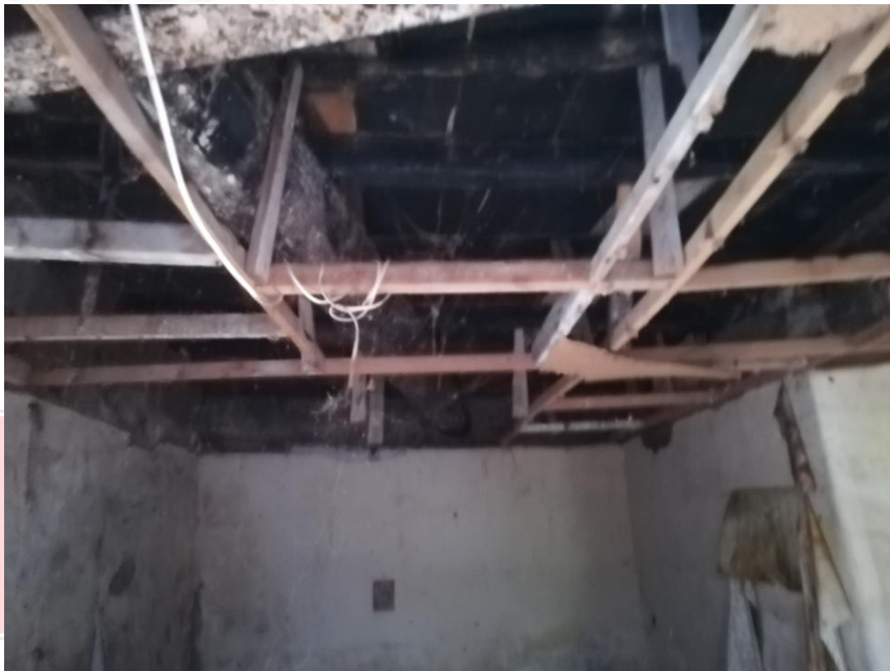
FOTO 9 – VISTA DEL SOLAIO PRECARIO SOTTOSTANTE ALL'UNITA'
