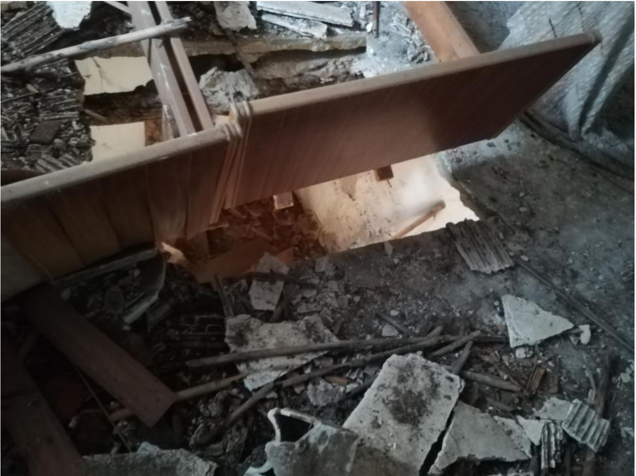
FOTO 5 – LETTO CON SOLAIO SOTTOSTANTE CADUTO
