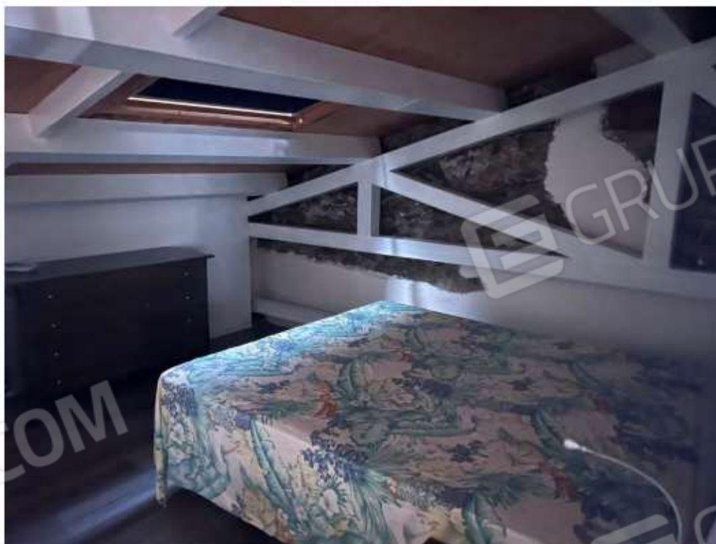
Figura 13 Vista camera realizzata in difformità alla concessione edilizia
