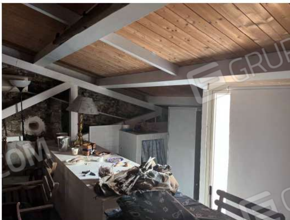
Figura 10 Vista angolo cottura e uscita veranda realizzata in difformità alla concessione edilizia
