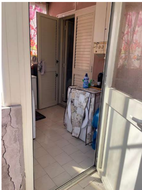
foto n. 25 struttura precaria in alluminio e vetro realizzata sul balcone prospiciente la via pubblica
