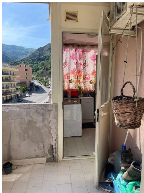
foto n. 29 struttura precaria in alluminio e vetro realizzata sul balcone prospiciente la via pubblica
