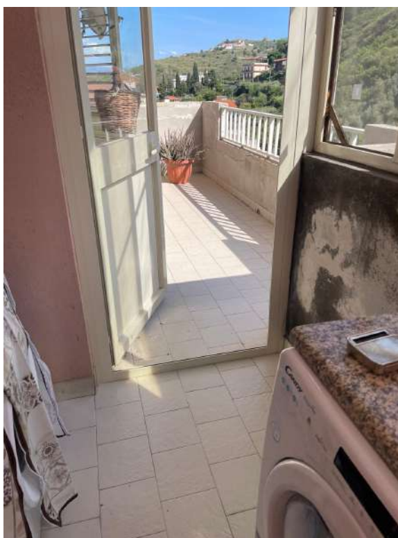
foto n. 26 balcone prospiciente la via pubblica: vista dall'interno della struttura precaria realizzata
