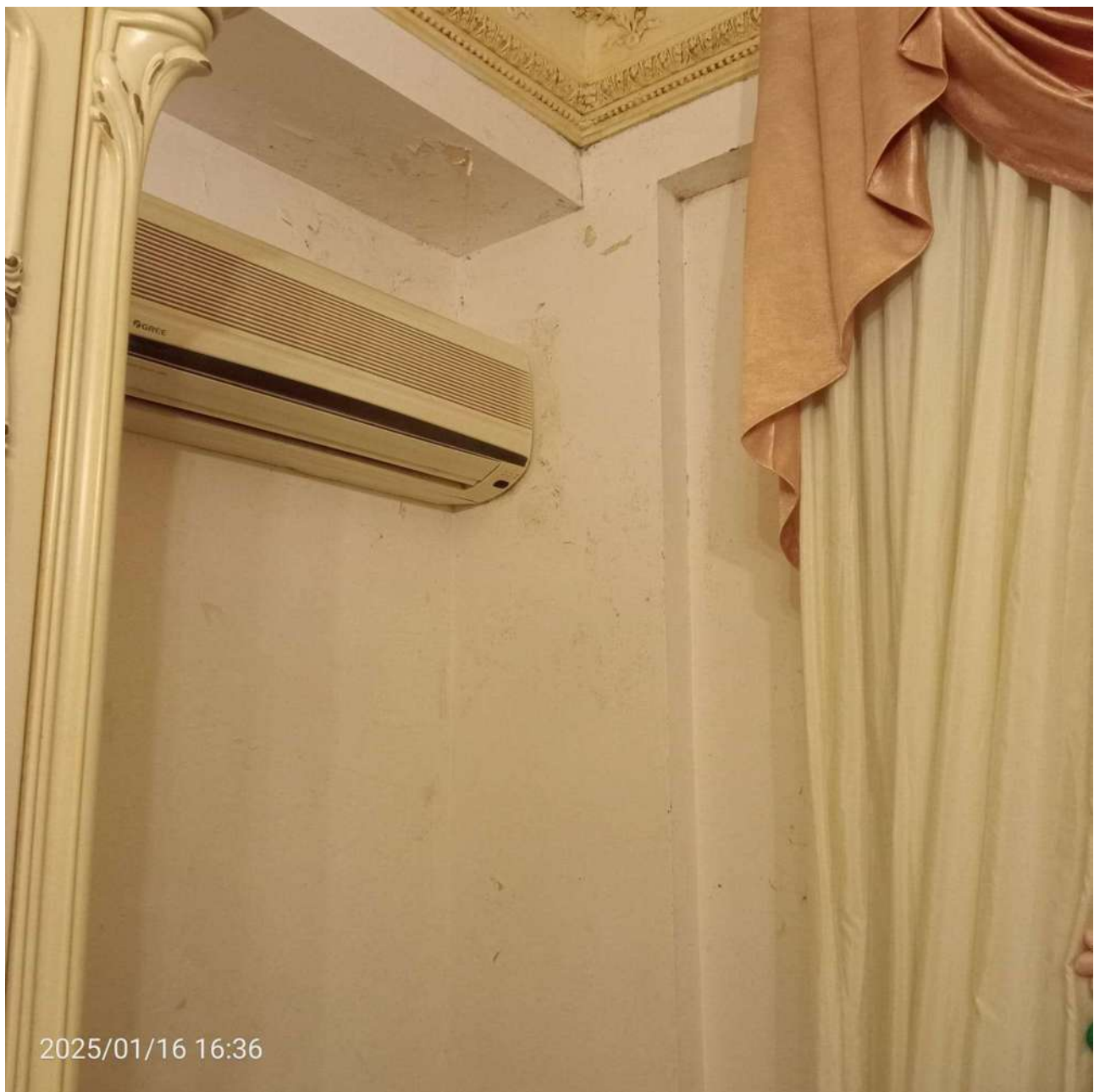
Foto 9 - Vista interna dei fenomeni infiltrativi nella camera da letto.
