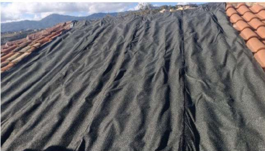
foto 2- "Riparazione" locale con sovrapposizione di guaina bituminosa
