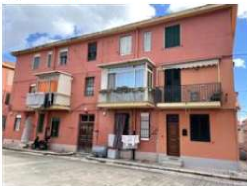
Balcone con struttura precaria di chiusura su corte interna
