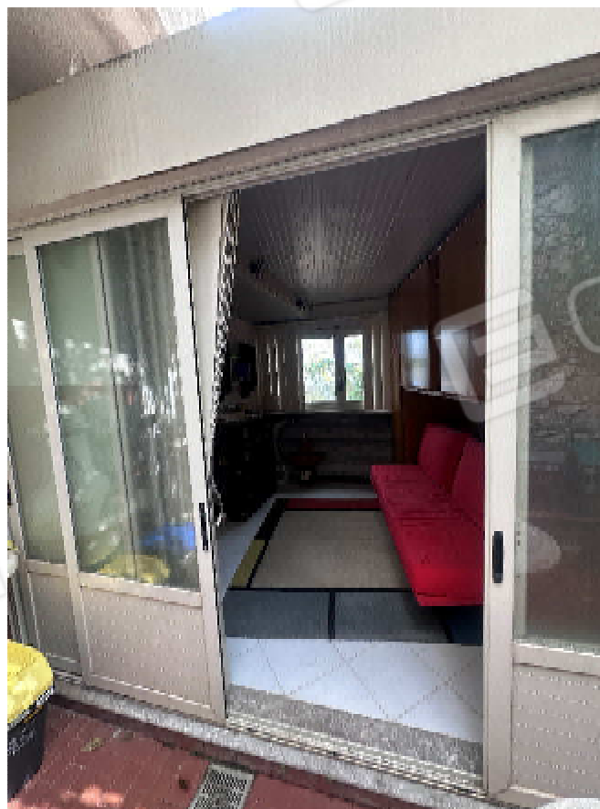
Foto nr.12: volume privo delle necessarie autorizzazioni
