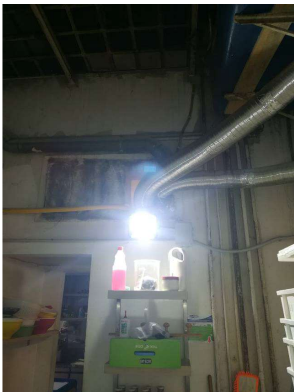
Foto n. 11 : Chiostrina –dettaglio impianto di areazione;
