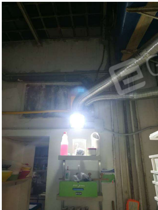
Foto n. 11 : Chiostrina –dettaglio impianto di areazione;
