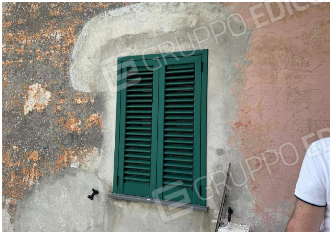
Foto 45 – Affaccio finestra Camera 2, cavillature e scrostamento della tinteggiatura superficiale
