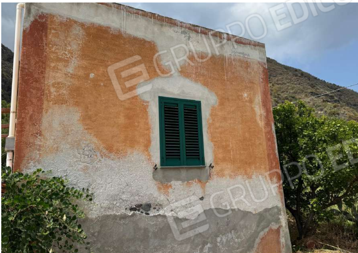
Foto 41 – Interventi di risanamento incompleti sulla parte bassa del prospetto Nord
