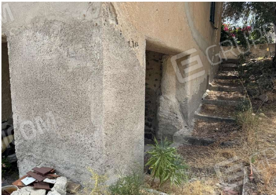
Foto 48 – Lesioni profonde in prossimità dei varchi di accesso ai depositi sui prospetti Ovest e Sud
