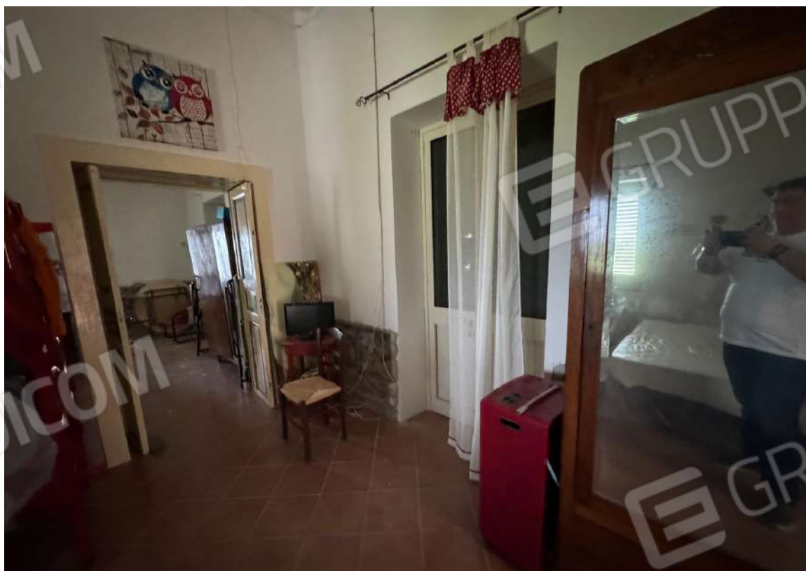
Foto 24 – Camera 2 – Particolare dei cavi dell'impianto elettrico a vista
