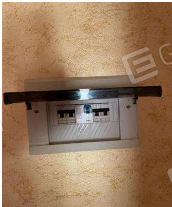
FOTO 18 – PIANO PRIMO QUADRO ELETTRICO
