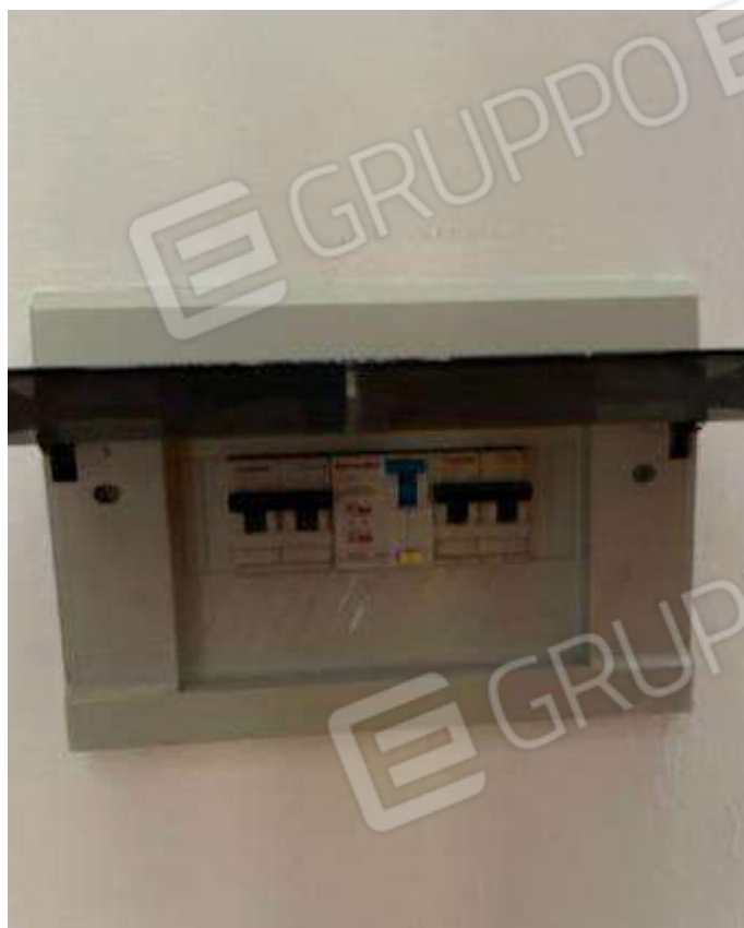
FOTO 33 – PIANO SECONDO QUADRO ELETTRICO
