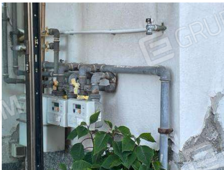
FOTO 20 – PIANO TERRA CONTATORE GAS
