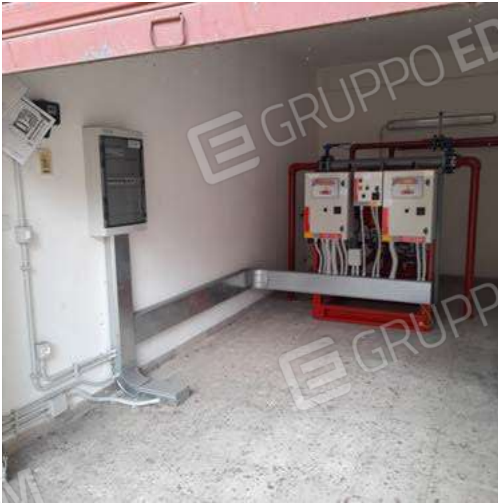
Foto 5- Macchinari e impianti
