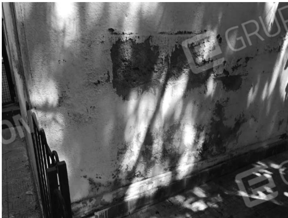
Foto n.6 Prospetto della villa ammalorato da umidità di risalita
