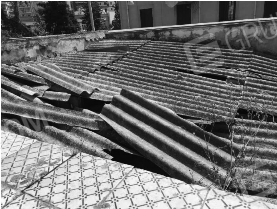
Foto n.38 Terrazza coperta con cemento amianto
