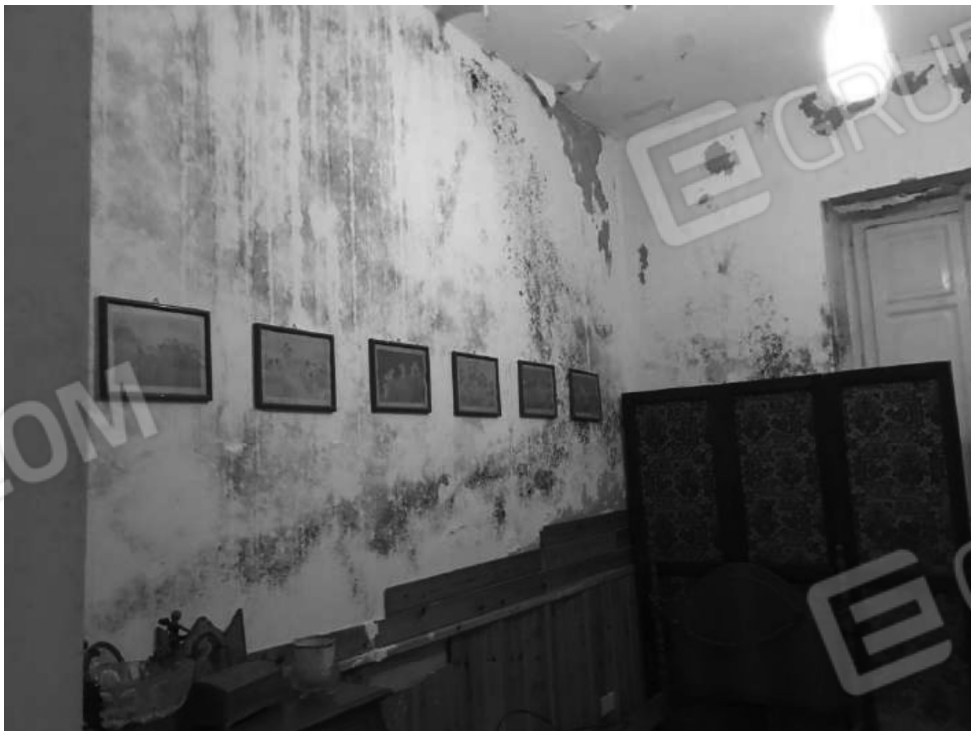
Foto n.16 Pareti ammalorate in una camera a piano rialzato
