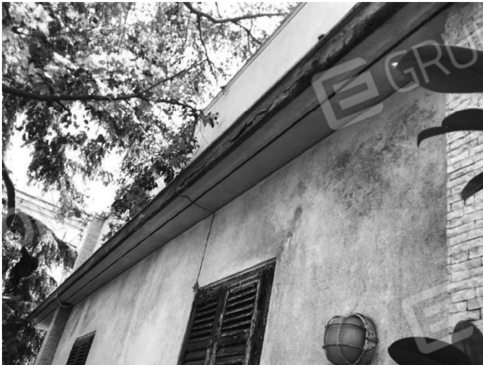
Foto n.4 Particolare del prospetto della villa ammalorato
