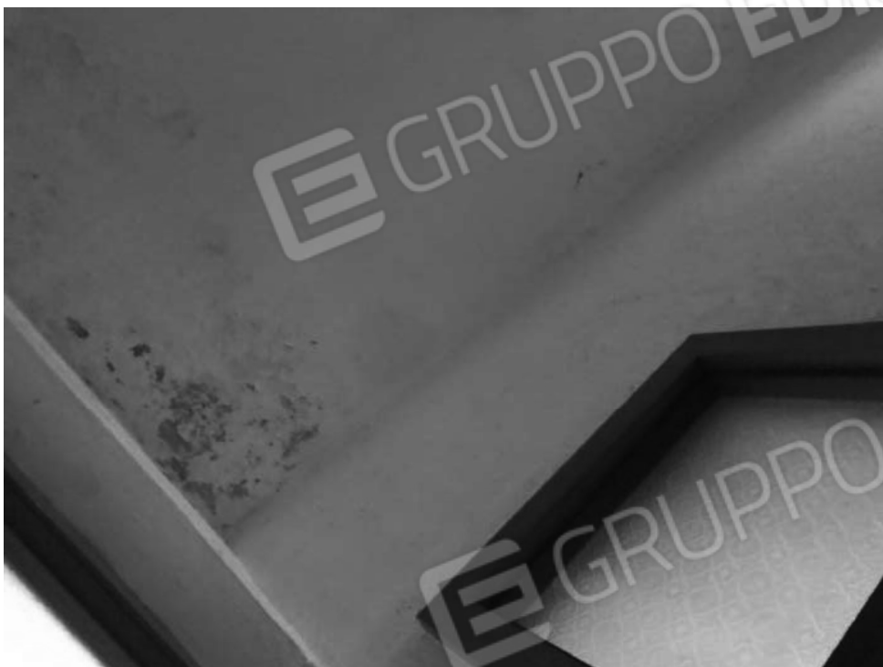
Foto n.25 Macchia umida nel soffitto della cucina a piano rialzato
