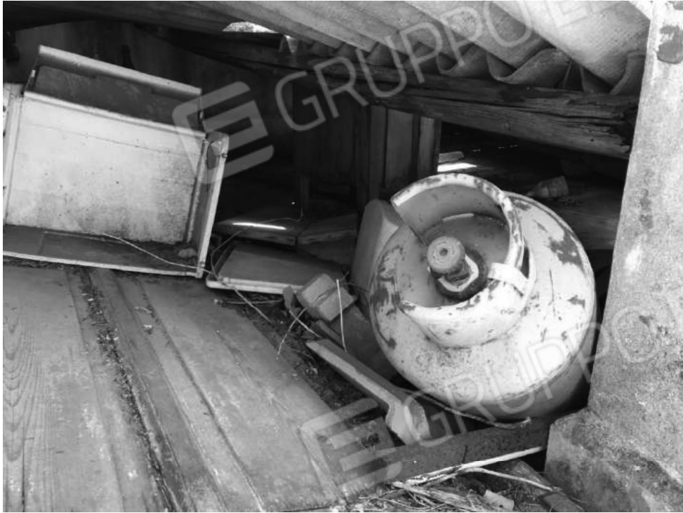
Foto n.39 Parte della terrazza coperta con cemento amianto
