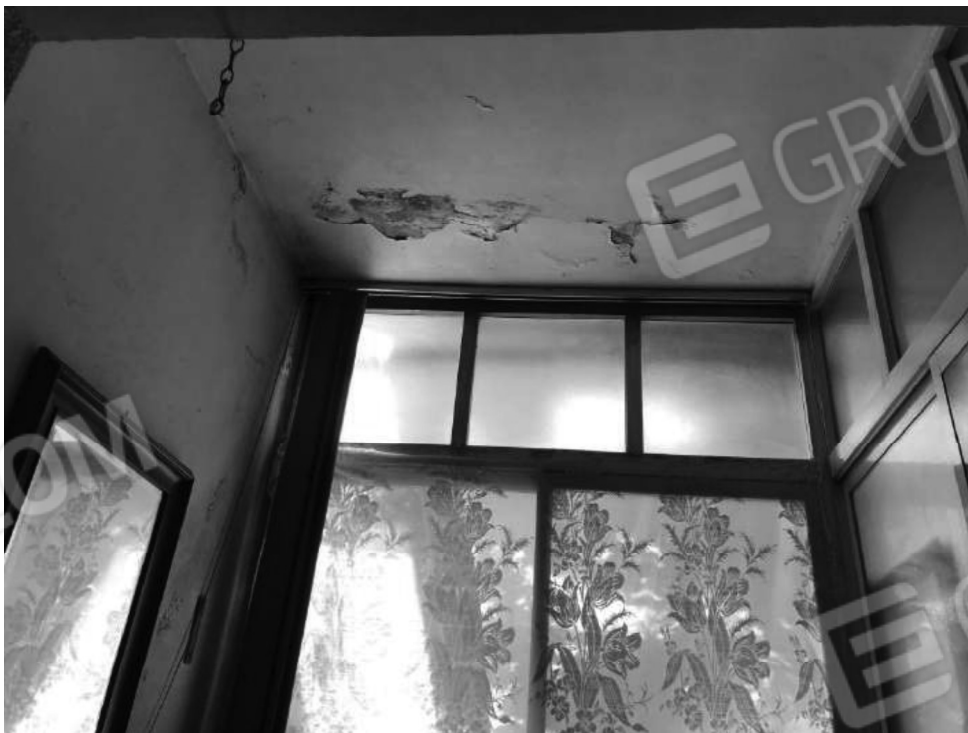
Foto n. 22 Intonaco soffitto pericolante in una camera a piano rialzato
