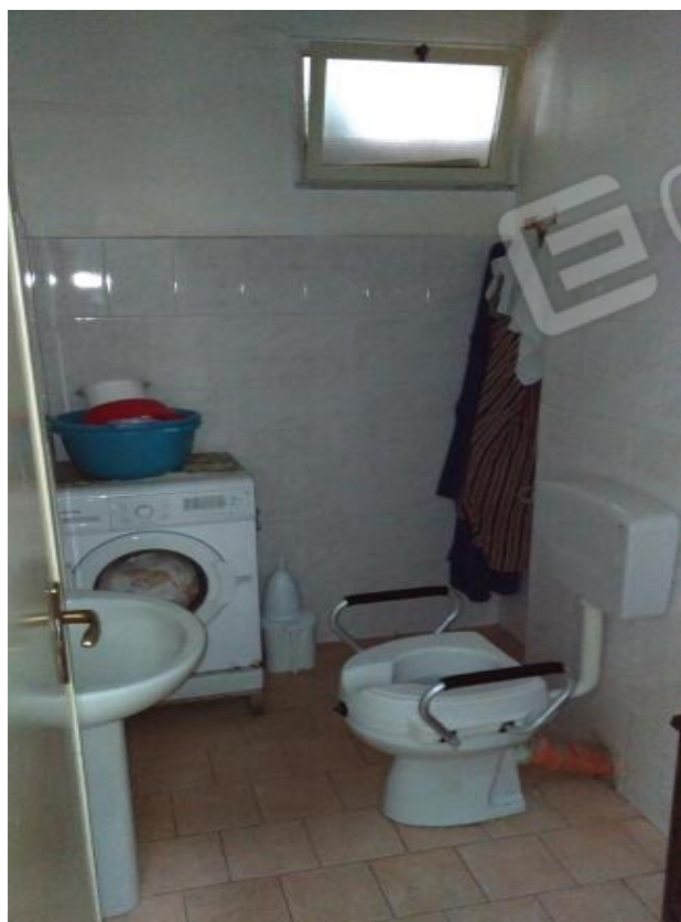
FOTO 86– W.c. per disabili
