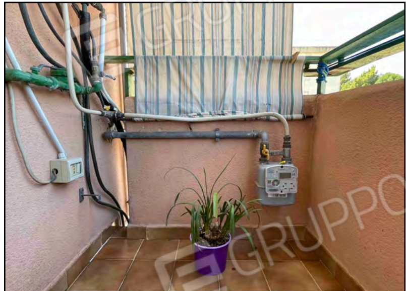
Impianto del gas
