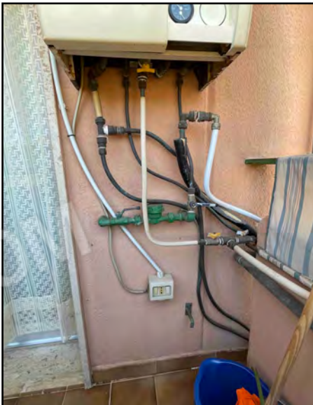
Caldaia sul balcone
