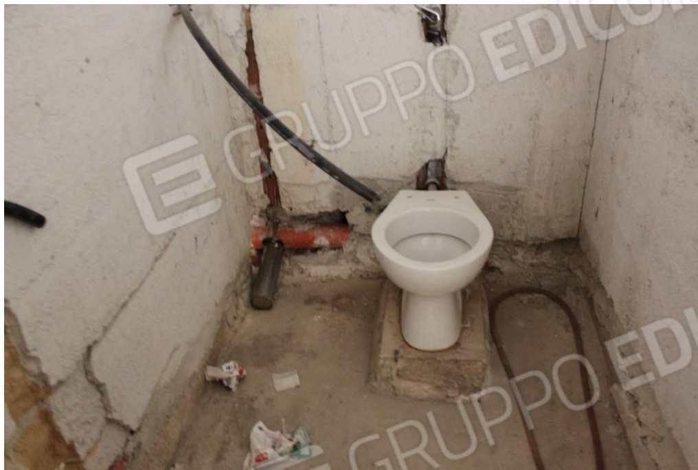
Immagine D3 – 25 Particolare - impianti
