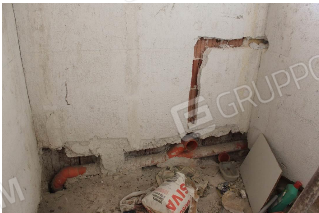
Immagine D3 – 24 Particolare - impianti
