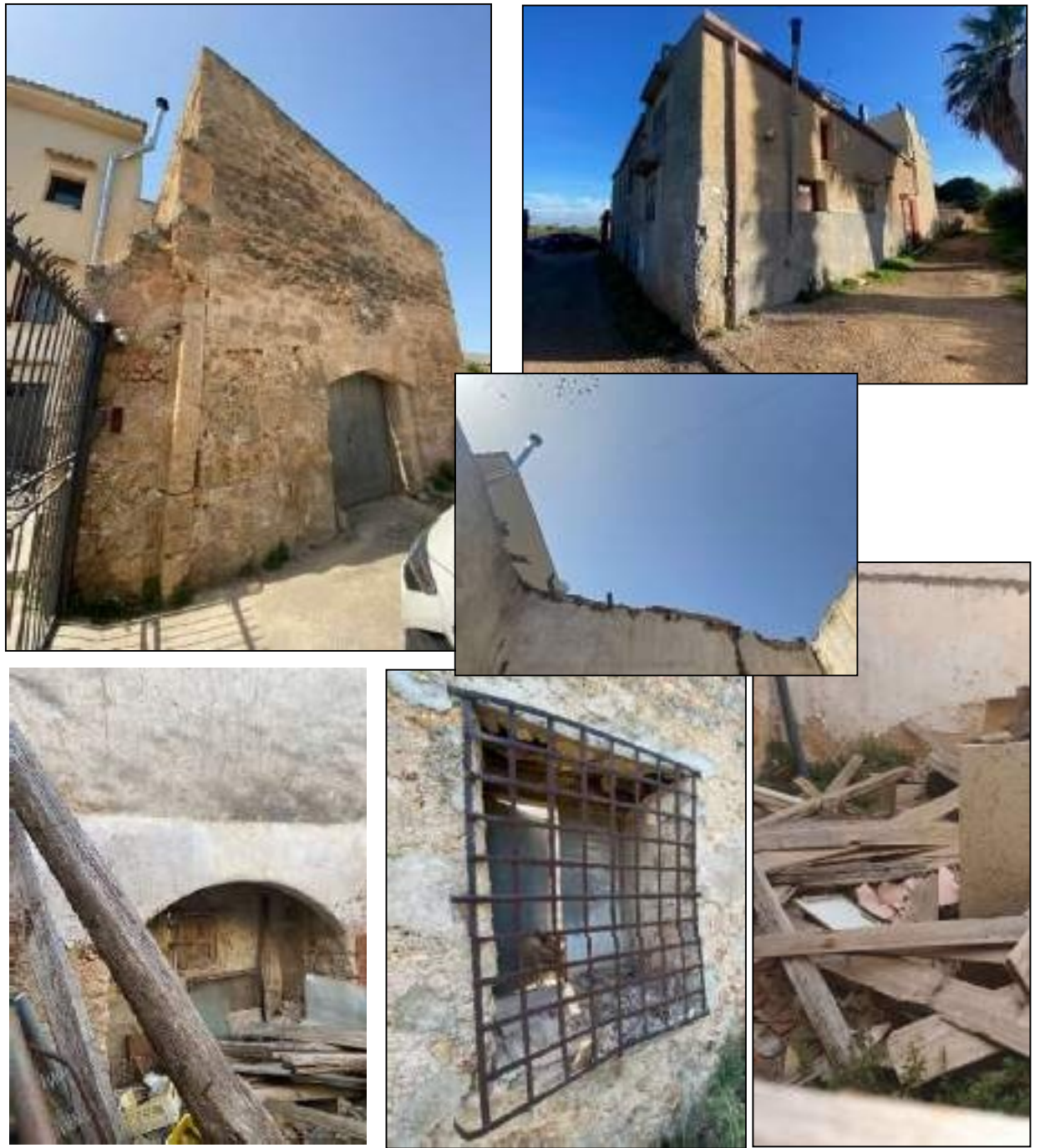
Figura 3: Elementi fotografici di dettaglio del fabbricato rurale diruto con evidenza della assenza di copertura
