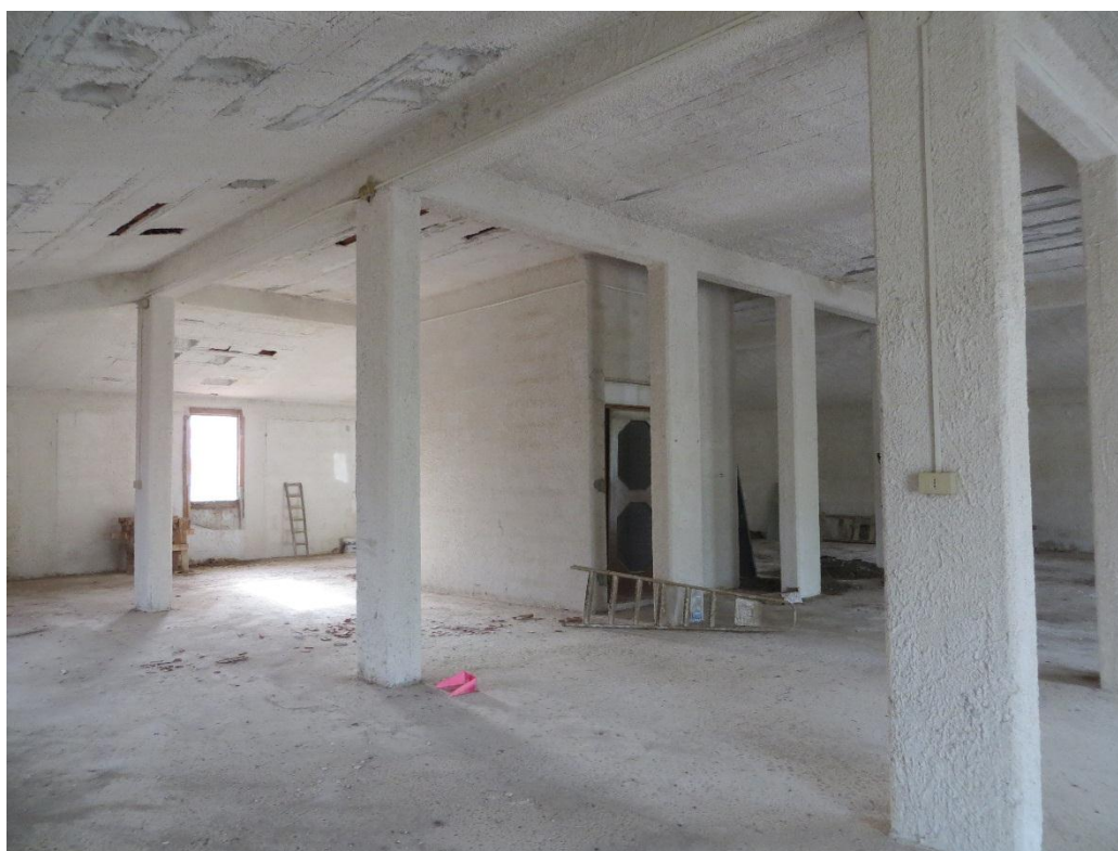
Foto 5-6. Secondo piano dell'edificio in corso di costruzione. Zona a destra salendo le scale corrispondente al subalterno 14
