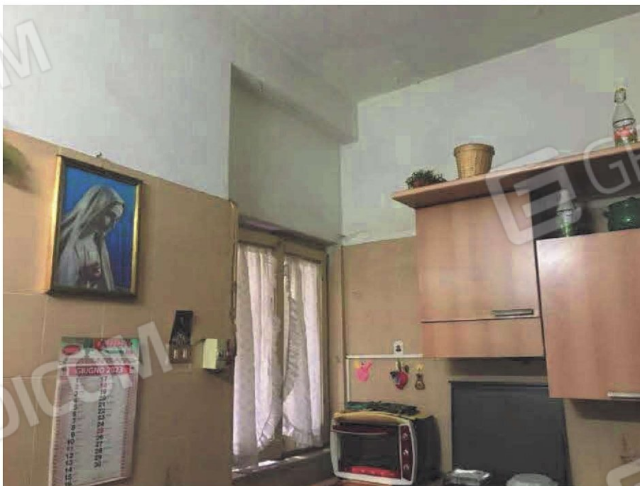
Foto n.18 Particolare ammaloramenti trave e soffitto in cucina
