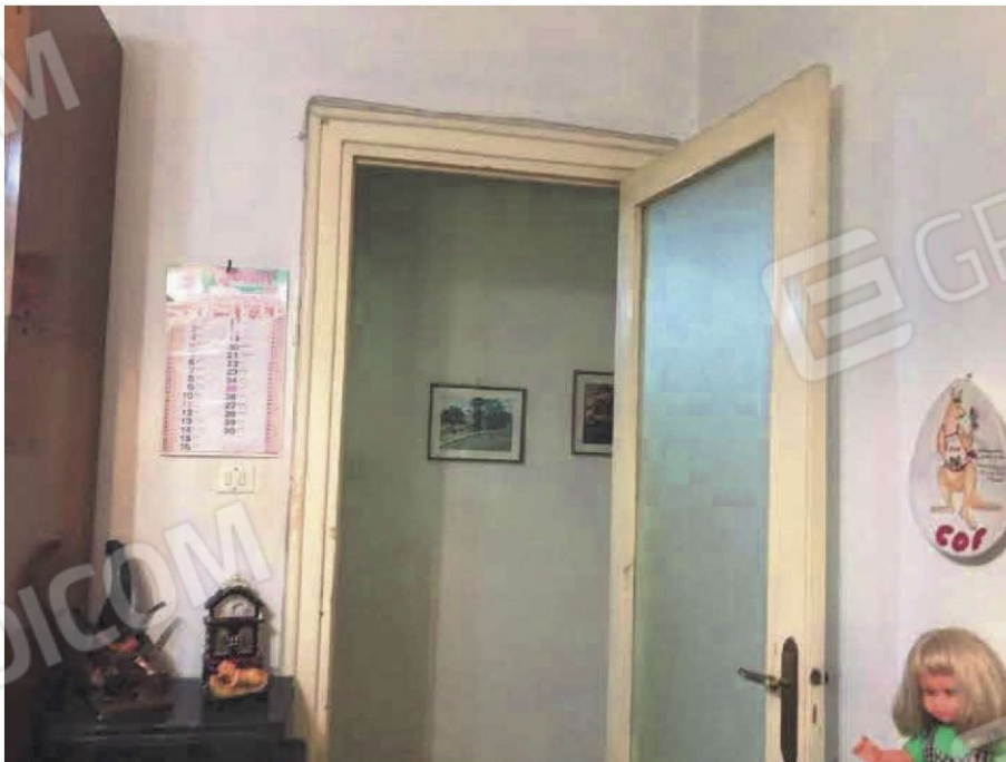
Foto n.10 Particolare impianti a vista in una camera
