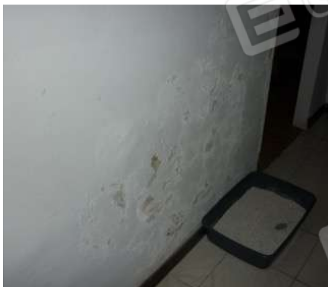
Foto n. 13 – Pareti con segni di umidità
