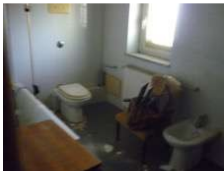
Servizio che ricade nella porzione di immobile appartenente alla limitrofa unità immobiliare
