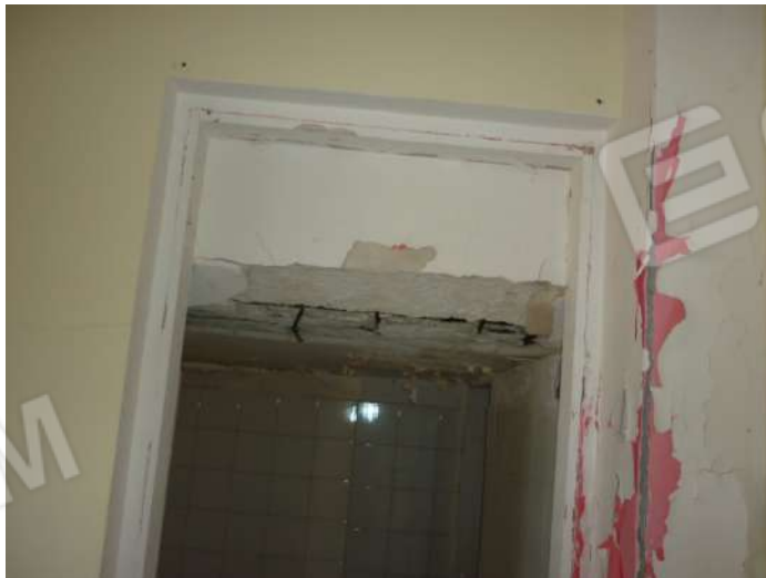
Foto n. 11 – Dissesti alla struttura del solaio con distacco di intonaco e ferri di armatura scoperti
