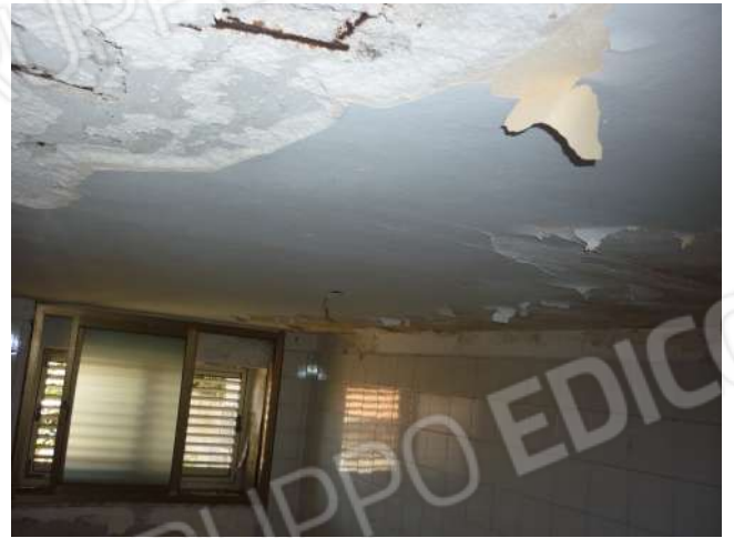
Foto n. 10 – Dissesti al solaio della porzione di immobile realizzata senza autorizzazioni
