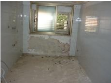
Cucina che ricade nella porzione di immobile chiusa senza autorizzazione
