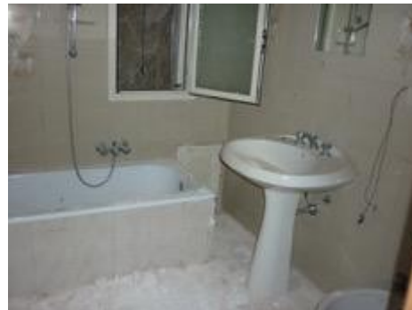
Servizio igienico che ricade nella porzione di immobile chiusa senza autorizzazione
