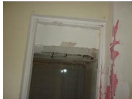
Degrado delle strutture con ferri scoperti e di sezione ridotta
