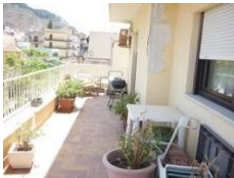
Dissesti al rivestimento esterno con distacco dello strato di finitura
