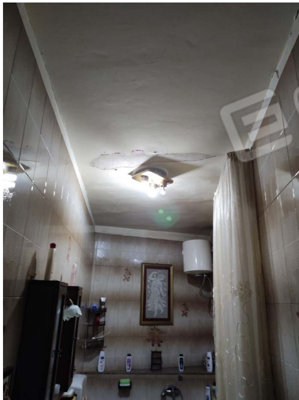
FOTO 12: Particolare bagno infiltrazioni
