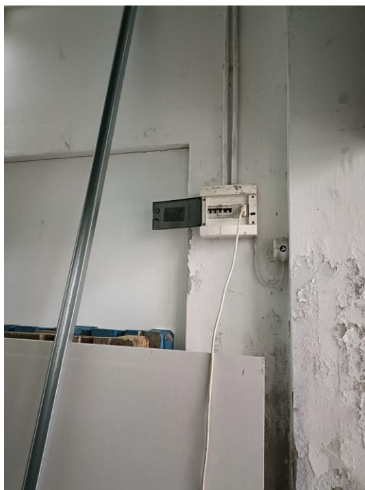
Foto n. 4 – dettaglio impianto elettrico
