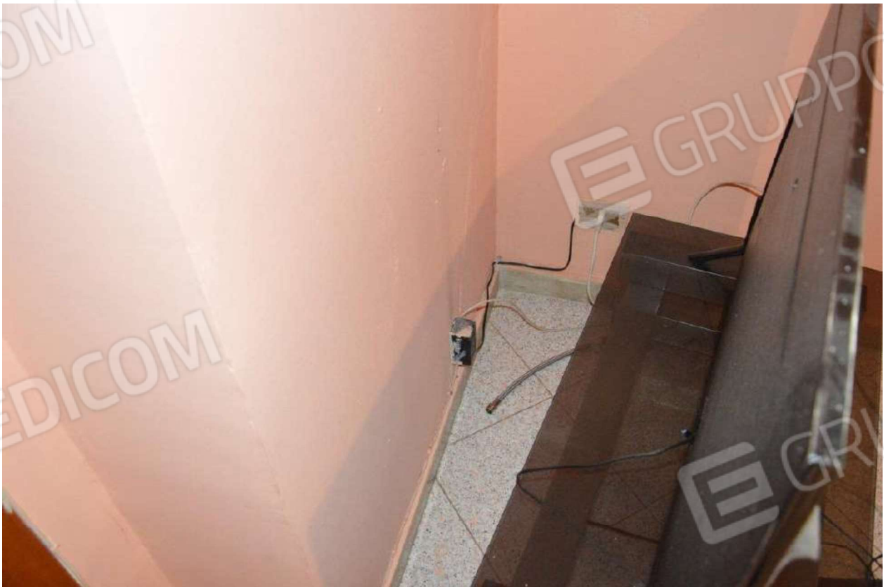
FOTO 18. Particolare impianto elettrico
