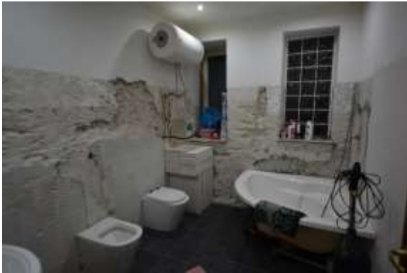
All. 9 – Foto 7 Wc bagno
