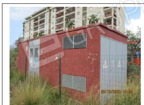
Foto 23. Cabina elettrica identificata al sub. 10 della p.lla 1050
