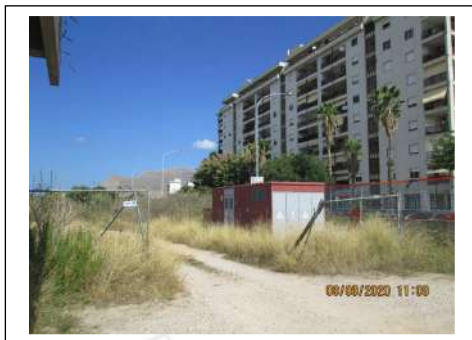
Foto 22. Cabina elettrica identificata al sub. 10 della p.lla 1050
