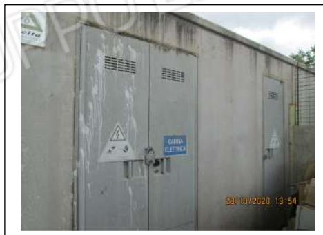
Foto 19. Cabina elettrica identificata al sub. 9 della p.lla 1050
