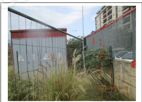
Foto 24. Cabina elettrica identificata al sub. 10 della p.lla 1050
