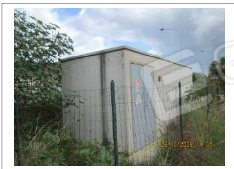
Foto 18. Cabina elettrica identificata al sub. 9 della p.lla 1050
