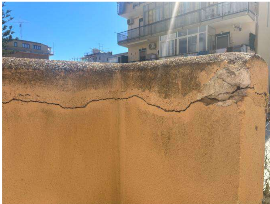
Foto n. 17 - Lesione sul muro del terrazzo
