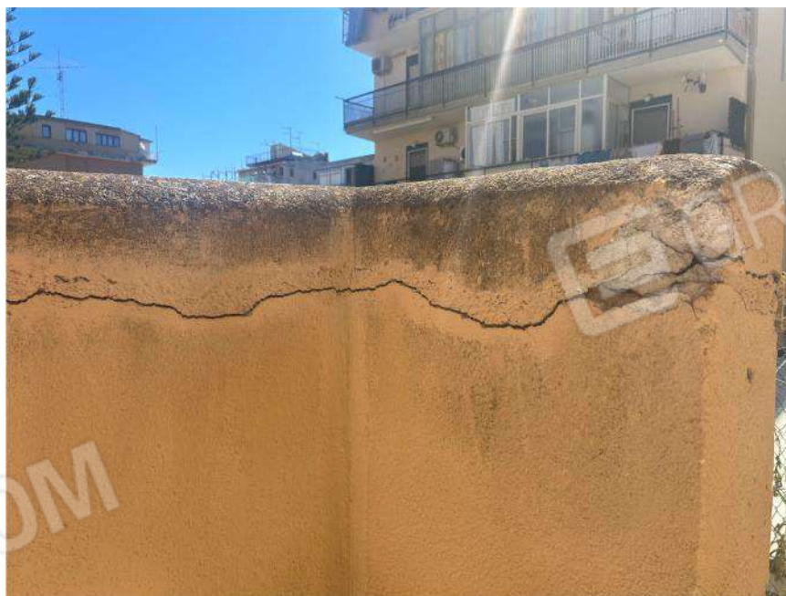
Foto n. 17 - Lesione sul muro del terrazzo
